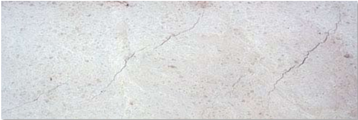
Foto 1: Plastische krimp-scheuren in bovenaanzicht, waar ze doorlopen tot aan de onderkant vloer (type F)
