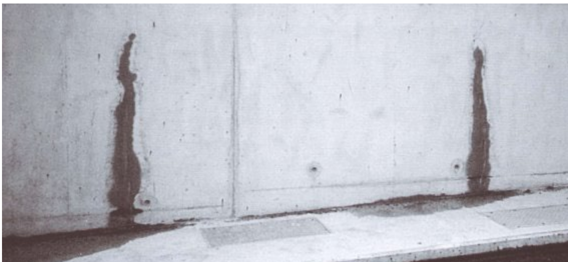
Foto 4: Scheuren ontstaan door verhinderde vervorming, verticaal en doorgaand (type H)
