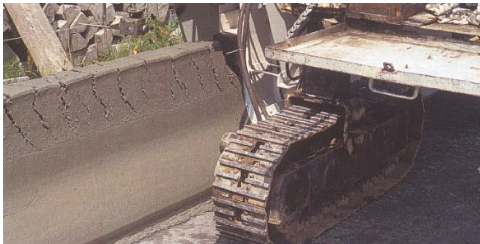
Foto 3: Trekscheuren bij aanleg voertuigkering
