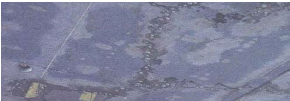
Foto 2: Plastische krimp-scheuren in onderaanzicht, waar ze doorlopen tot aan de onderkant vloer (type F)
